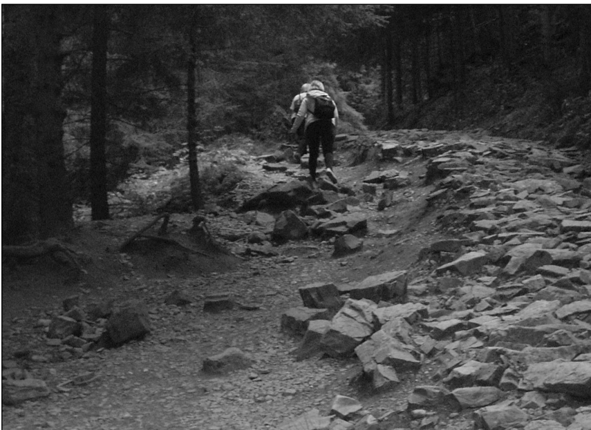
Fot. 9. Źle przygotowana nawierzchnia – podejście na Boczań
